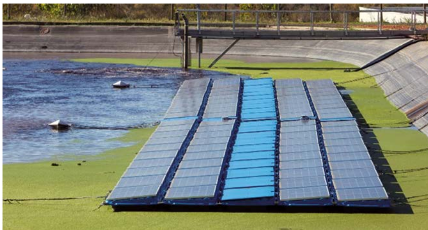
Figura 4. Campo fotovoltaico sobre estructura flotante en balsa
