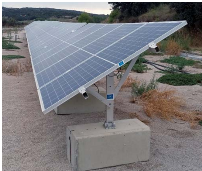
Figura 3. Campo fotovoltaico sobre estructura metálica en suelo
