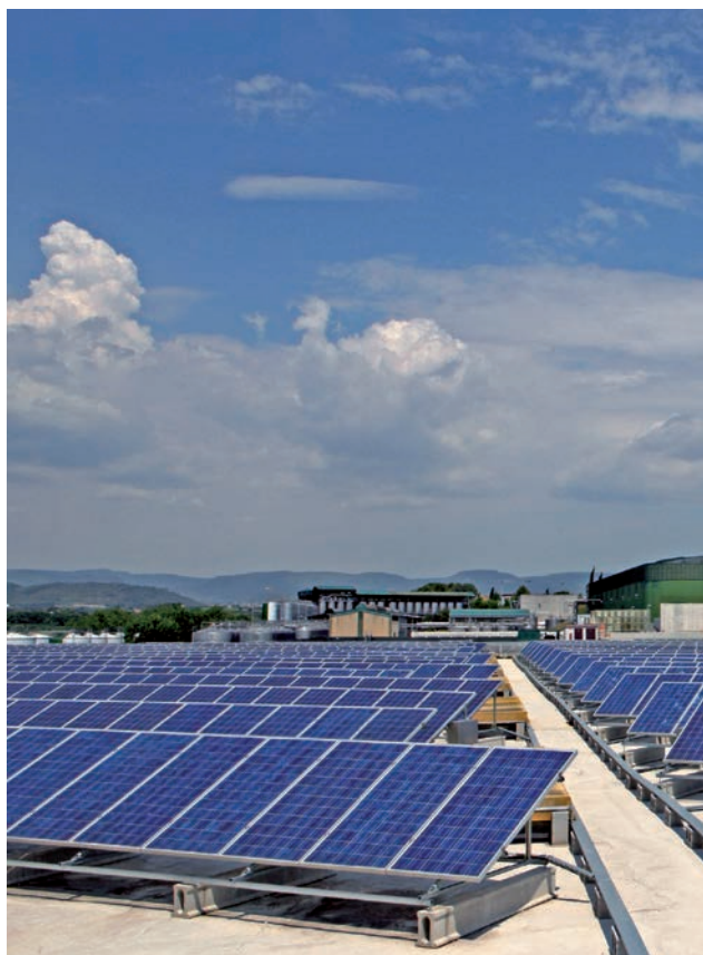
Figura 2. Placas fotovoltaicas en las instalaciones de Torres en Penedés
